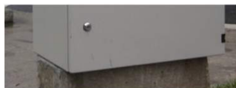
(Imagem: fixado em base de concreto)
